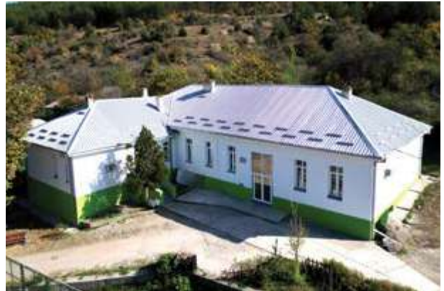
Реконструиран е кровот на училишниот објект во ПУ „Браќа Миладиновци“ – с. Пчиња.
